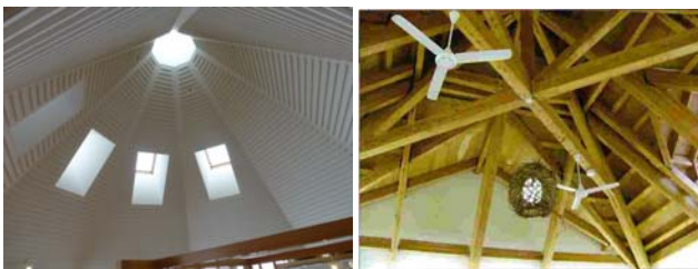
写真-4 左：熱効率が悪い吹き抜け(イメージ) 右：掃除に苦労する吹き抜け(イメージ)
