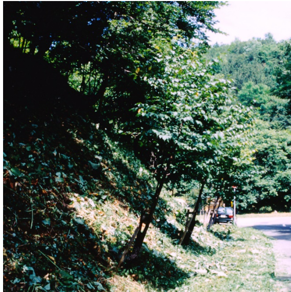
写真 4-4 雪圧に対する配慮を怠り雪圧で傾いた例 21)
