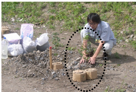
写真 2-8 カミネッコンと設置状況
