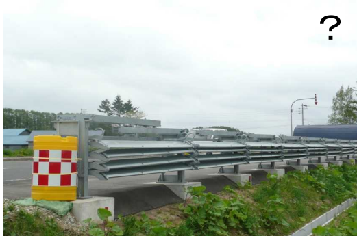
折りたたみ式では、道路の外部景観を大きく阻害。地域の田園景観に与える影響も小さくない。
