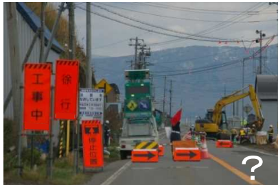
同じ場所に、蛍光色で誘目性が高い仮設の標識等が多数設置されており、より重要な誘導員が目立たない。
