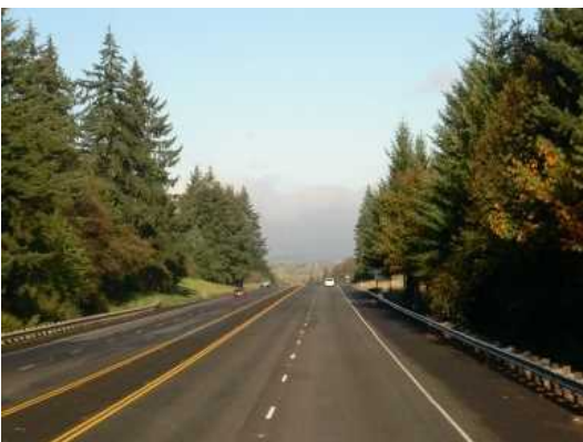
支柱が木製のガードレール
