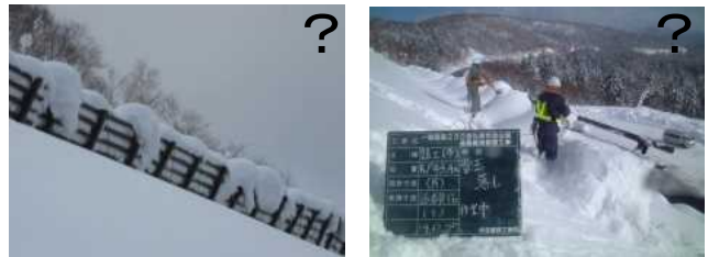
雪崩防止柵についての雪の定期的な雪落としにより多大な維持コストが発生
