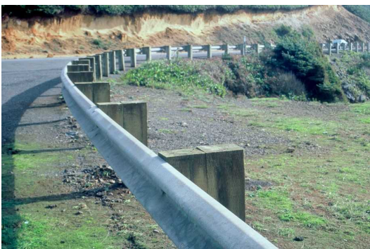
支柱が木製のガードレール
