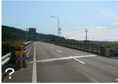
橋梁の親柱に反射板・視線誘導標・クッションドラムが連鎖的に整備されている事例
