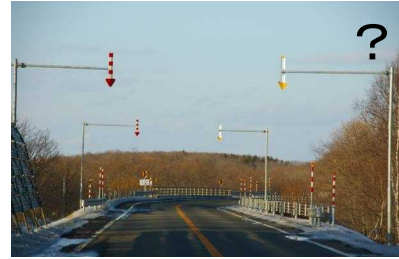
除雪管理用の伸縮式視線誘導標と視線誘導も兼ねた矢羽根の併設している事例。 (10年確率最大積雪深 約70cm)。
