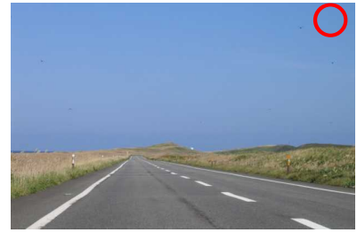
伸縮式視線誘導標で良好な景観が確保されている事例。
