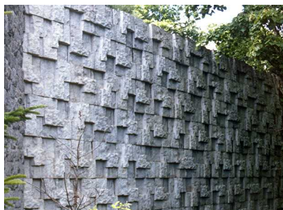
大きな段差があるブロックを回転させながら用いることで、表情豊かな面を生み出している。
