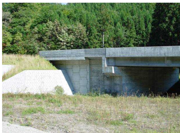
橋台の側面が極めて煩雑なおさまりになっている事例。さらに、補強土壁や積みブロックなどが混在しているため、より混沌とした景観が形成されている。
