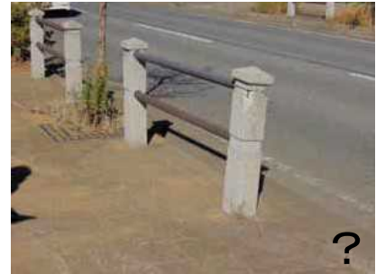
防護柵に御影石を併用しているが、防護柵の変形や破損に際し、迅速な修繕・復旧が難しい。(出典:資料1)
