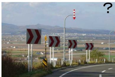
ビューポイントにおいて、防護柵直近に設置した矢羽根の事例。 スノーポールとさらにシェブロンが併用されている。
