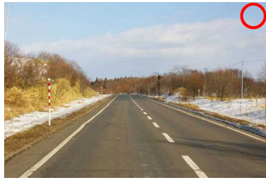
伸縮式視線誘導標により比較的良い景観が確保されている。
