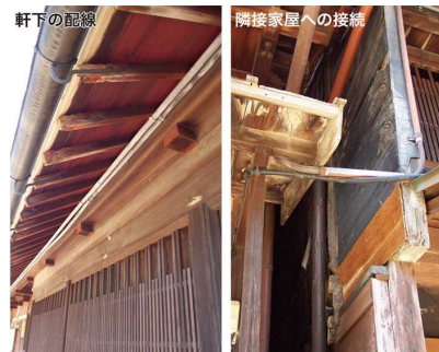
軒下配線の写真
