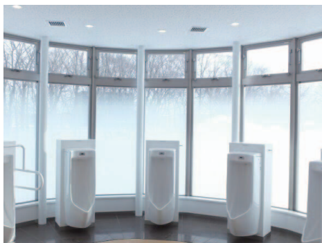
▲トイレの利用は、24時間可能。トイレが清潔で快適であることは、道の駅自体の来訪者の増加にもつながる。
