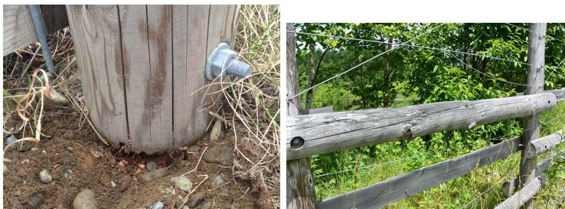
写真 4-5 支柱根元部分（地際）の腐朽劣化の例（左）と、剥皮丸太材の外観の例（右）
