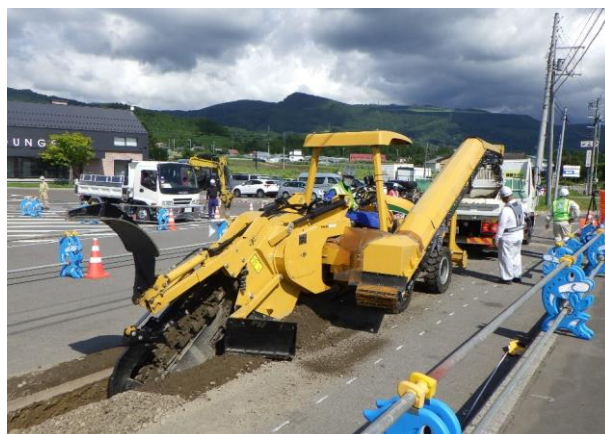
写真-2.8 電線共同溝工事での掘削状況 (令和3年度、国道5号「道の駅」なないろ・ななえ前)
