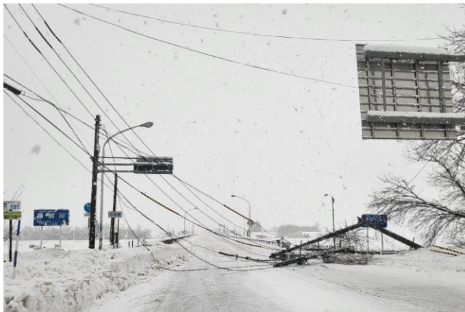
写真-1.27 暴風雪により倒壊した電柱 (北海道幕別町国道38号、2022.12)
