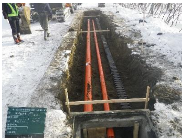
写真-2.1 浅層埋設試験管路（北海道美深町H30～R2） 土被り13cm～70cmまでの試験管路を構築し、管路内温度測定で凍結しない深さ60cmを確認
