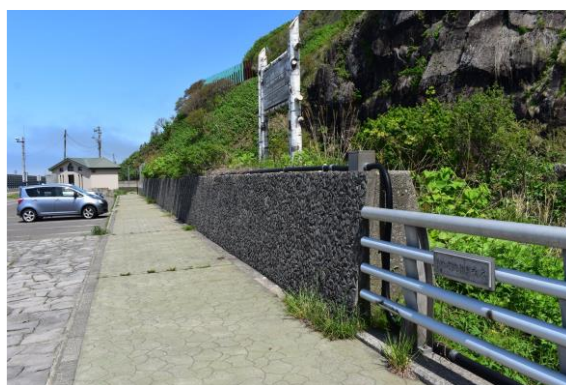
写真-2.38 擁壁の天端に配管を固定し、通信線を敷設している地上配線（擁壁配線）の事例
