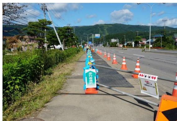
写真-2.3 簡易な転落防止措置での開放状況
