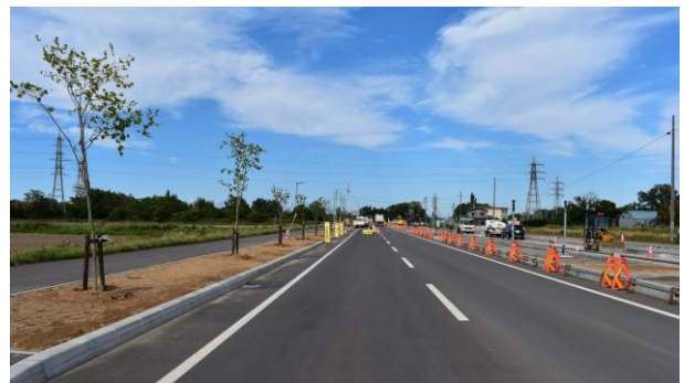
写真-3.27 道路の新設に併せて単独地中化を実施 効率的でありコスト縮減が期待できる
