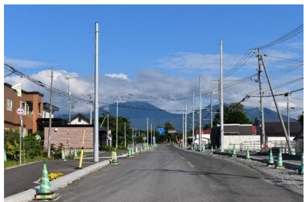
写真-3.30 道路工事の際、道路法第72条監督処分により電柱を移設させたが、移設先の占用協議で、むしろ車道側に近づけてしまった事例
