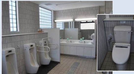
▲水源が2系統あり、停電時でも使用可能なトイレ[道の駅たろう(岩手県)] ※出典：未知スタイル第22号(2011年5月)
