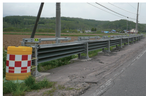
▲柵の端部にクッションドラムが設置され、施設の連鎖がおきている
