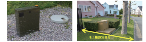
▲狭隘道路や郊外部に適した地上機器の小型化・集約の事例。(デンマーク) ▲地上権を設定した地上機器設置事例。欧米では民地提供の義務付けを法制化している。※写真提供: NPO電線のないまちづくり支援ネットワーク
