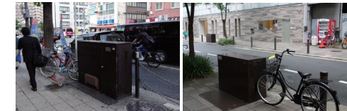
▲(左・右)大阪市内の地上機器。地上機器は設置される地域により規格が異なる。
