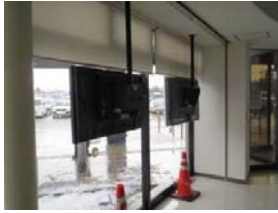
写真-10 屋外からも確認できるモニターによる情報提供
