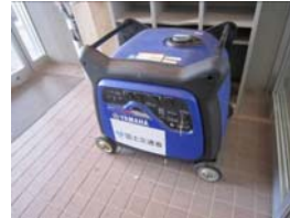
写真-13 被災時に自家発電機を借りて対応していた事例
