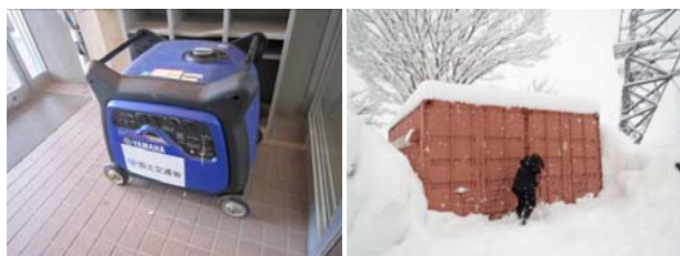
写真-15 被災時に自家発電機を借りて対応することも必要(左)、備蓄庫は除雪など冬期の適切な維持管理も必要(右)
