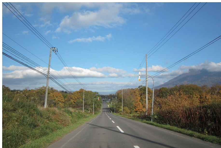
同一路線で電力・通信線共に両側への占用許可がされている事例は多い
