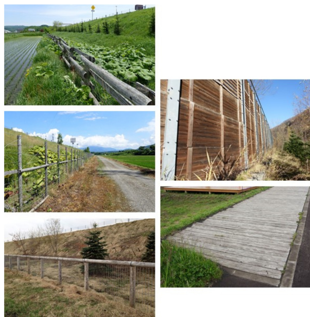
写真-2 調査対象とした木製工作物 （左列：立入防止柵、右上：防雪柵、右下：歩道舗装）
